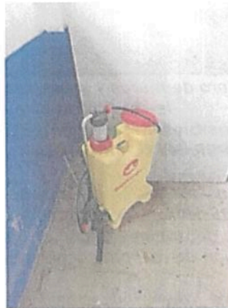
Imagen 5. Inadecuado almacenamiento de equipo fumigador en cuarto de plantas eléctricas.
