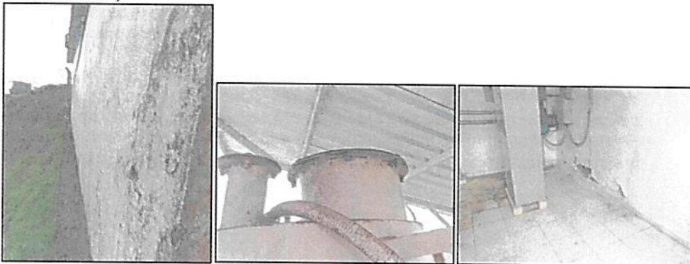
Imagen 2, 3, 4. Deterioro de muros y presencia de pastos y arbustos en estación de Telefónica – Movistar.
